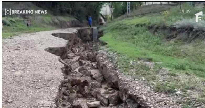
Fig. nr. 1. Drum degradat de curgerea apei, pe direcția deal-vale, în satul Vinderei, 14.09.2024
