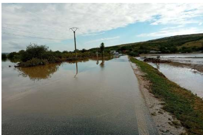
Fig. nr. 4. Acoperirea cu apă a Drumului Național 24D, timp de 5-6 ore, de către viitura produsă în data de 14.09.2024
